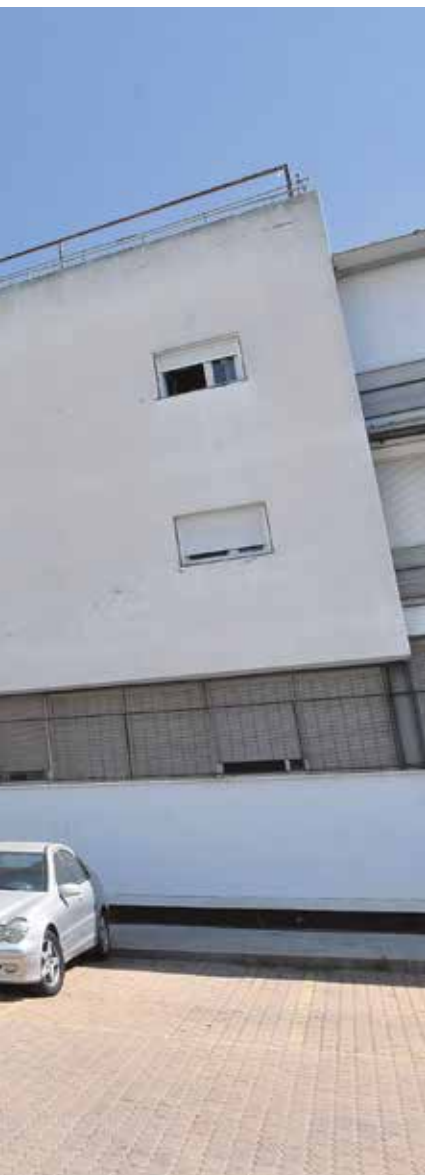
Reanudación de las obras de las viviendas sociales de la Plaza de la Cepa
