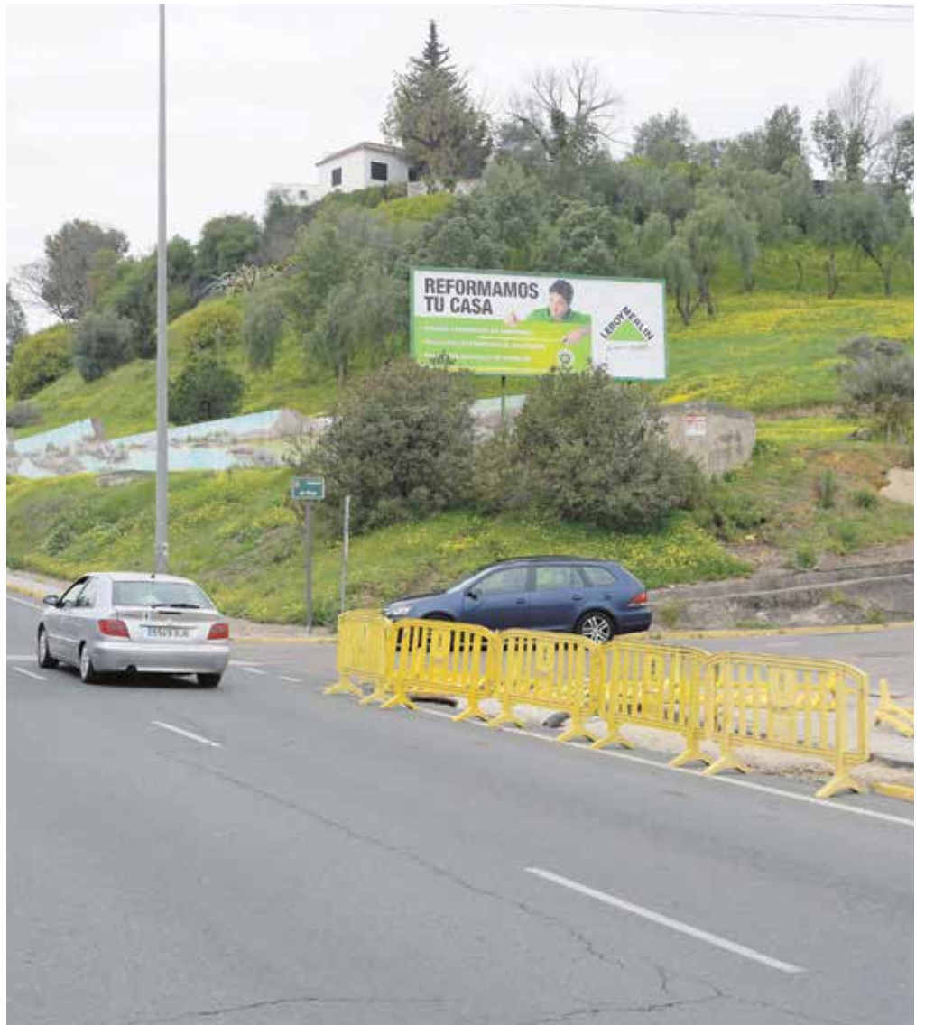
El objetivo de las obras es facilitar a los vecinos el acceso a Ciudad Parque y Santa Eufemia
