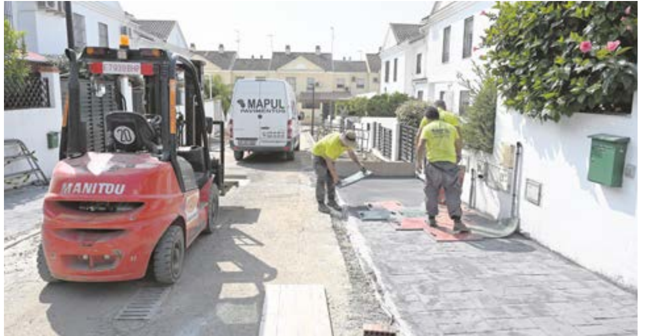
Operarios trabajando en las obras de la manzana 6 de Aljamar para mejorar las infraestructuras hidráulicas, entre otras actuaciones
